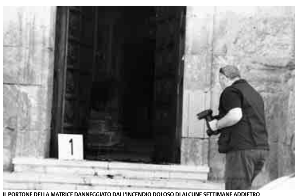
IL PORTONE DELLA MATRICE DANNEGGIATO DALL'INCENDIO DOLOSO DI ALCUNE SETTIMANE ADDIETRO
