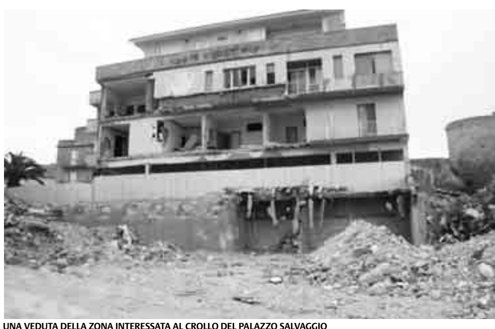
UNA VEDUTA DELLA ZONA INTERESSATA AL CROLLO DEL PALAZZO SALVAGGIO
