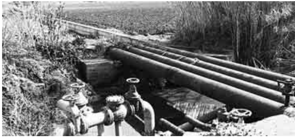
A sinistra una veduta della condotta idrica Gela Aragona croce e delizia dei licatesi perché molto spesso presa di mira dai ladri d'acqua e talvolta soggetta a vari guasti
